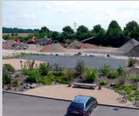
◀ Zur Erdwärmegewinnung wurden im Jahre 2008 1000 m Absorberleitungen aus Kunststoff vergraben und anschließend mit einer parkähnlichen Anlage begrünt.
